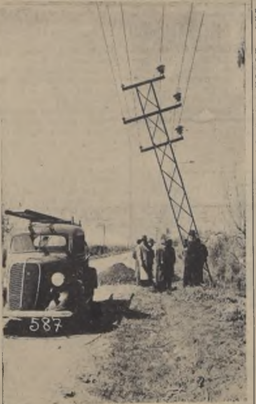
La torre 234, ubicada en el interior de un potrero cerca de Malloco, en cuya base los nacistas hicieron explotar una carga de dinamita. Quedó pendiente sólo de los gruesos cables conductores de electricidad. Ha sido necesario excavar el terreno para reponerla
