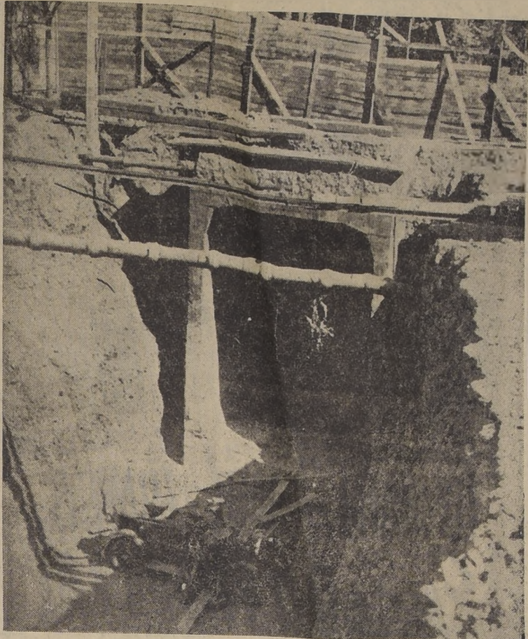
Estado en que quedó el coche en el fondo del túnel
