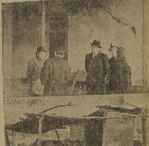
La comisión durante su visita a Tiltil. — Arriba: la muralla de un edificio seriamente dañado por el temblor del lunes. — Abajo: uno de los ranchos con sus murallones en el suelo
