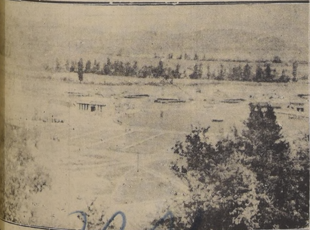
Vista panorámica de los trabajos en la Planta de "Las Vizcachas". A la derecha del grabado puede apreciarse el estanque puesto ayer en servicio
