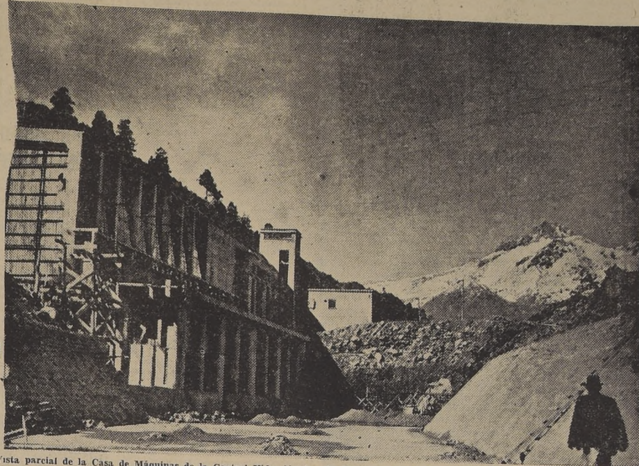
Vista parcial de la Casa de Máquinas de la Central Hidroeléctrica de Abanico, cuando la obra estaba en construcción. Al fondo, a la derecha, la cordillera de Sierra Velluda.
