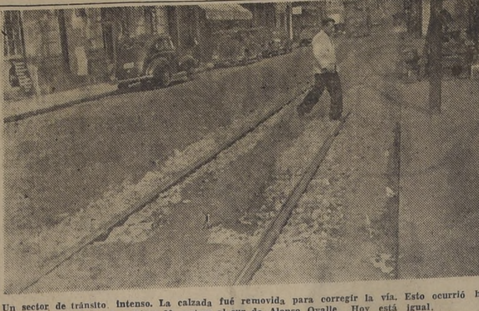
Un sector de tránsito intenso. La calzada fué removida para corregir la vía. Esto ocurrió hace un año en San Diego 20, metros al sur de Alonso Ovalle. Hoy está igual.
