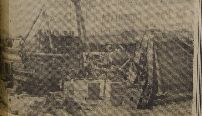
Vista de una de las estaciones de Bombeo del Oleoducto Camiri-Cochabamba, ramal Sucre
