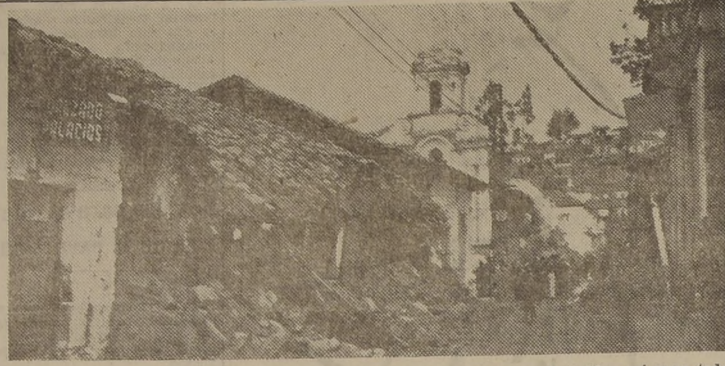
Calle en Ambato. Al fondo, la Iglesia de Santo Domingo, con sus torres destruidas, así como toda la nave. Fue construida a fines del siglo XVII. — (Foto ACME).
