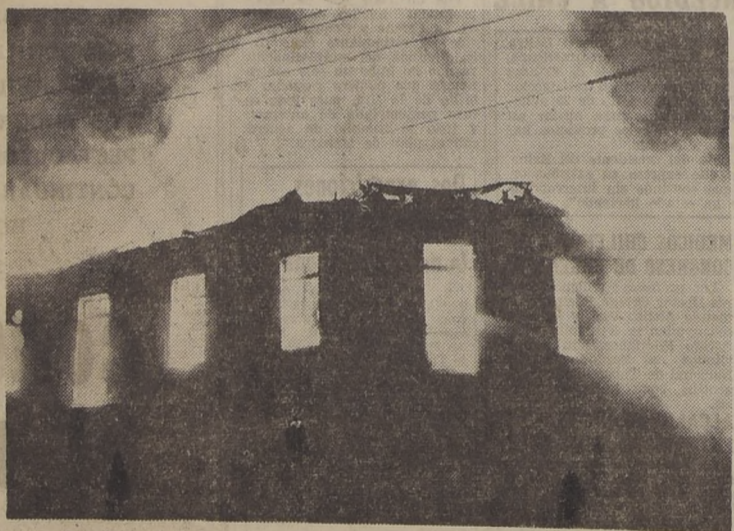
En la madrugada del miércoles, un violento incendio destruyó totalmente el edificio ubicado en Barros Arana esquina Cole Colo, del Arzobispado de Concepción, con pérdidas que ascienden a varios millones de pesos. Este es el tercer incendio que se produce en edificios de renta de propiedad del Arzobispado.— (Fotografía enviada por el corresponsal de LA NACION, José Velázquez E.).
