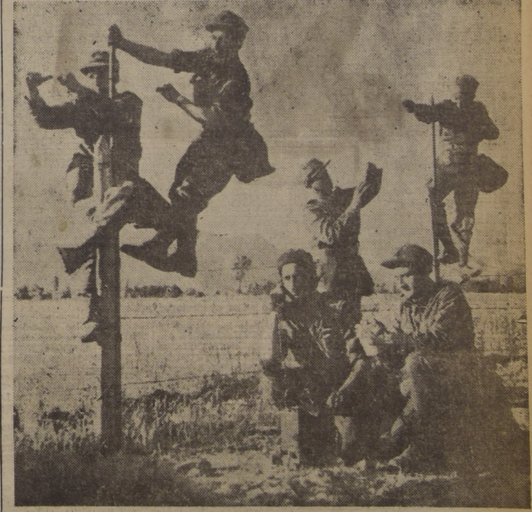
TRABAJOS TECNICOS EN PELDEHUE.— Aquí vemos una avanzada de la Escuela de Telecomunicaciones, construyendo las redes telefónicas para las grandes maniobras que culminarán el viernes, sábado y domingo próximos en Peldehue. En primer término, arriba, en pleno trabajo el sargento Gerardo Poblete y el conscripto José L. Castro. Abajo, el telefonista, cabo Manuel A. López; el revisor de líneas, conscripto Julio Aguilera, y los telefonistas, conscriptos Osvaldo Pérez y José Peña.
