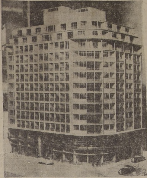
Aspecto que presenta actualmente el amplio y magnífico edificio que en la prolongación de la calle Matías Cousiño desde Moneda hasta Alameda, construye la firma de don Enrique Albetz. — Su propietaria es la Unión Española de Seguros
