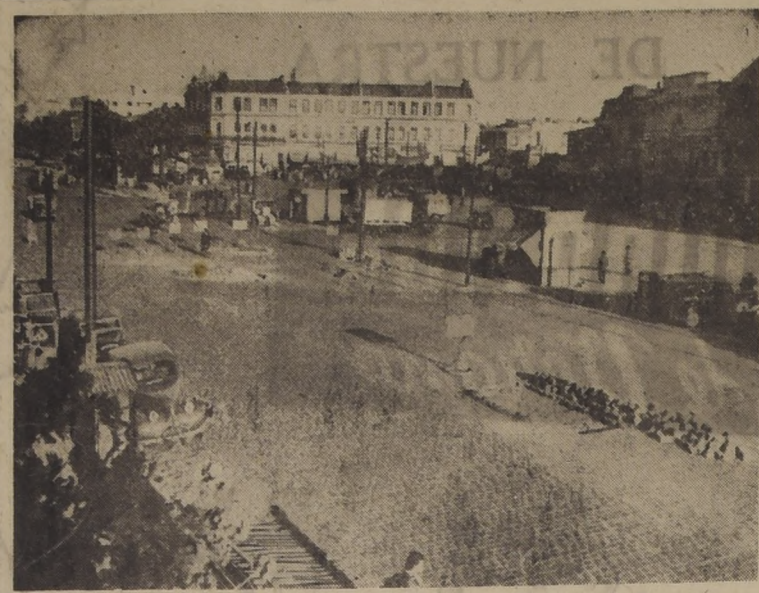
Los rótulos de la Dirección de Pavimentación, colocados ayer en diversos puntos de la Plaza Argentina, indican que se iniciaron inmediatamente los trabajos de reposición de la calzada, cuyo estado había provocado la paralización de seis líneas de microbuses que la atraviesan diariamente. Se calcula que los revestimientos de asfalto quedarán terminados antes de una semana.
