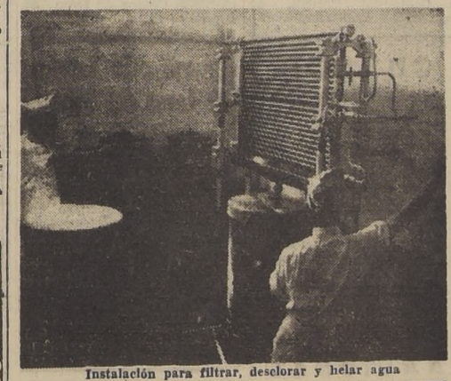
Instalación para filtrar, descolorar y helar agua
