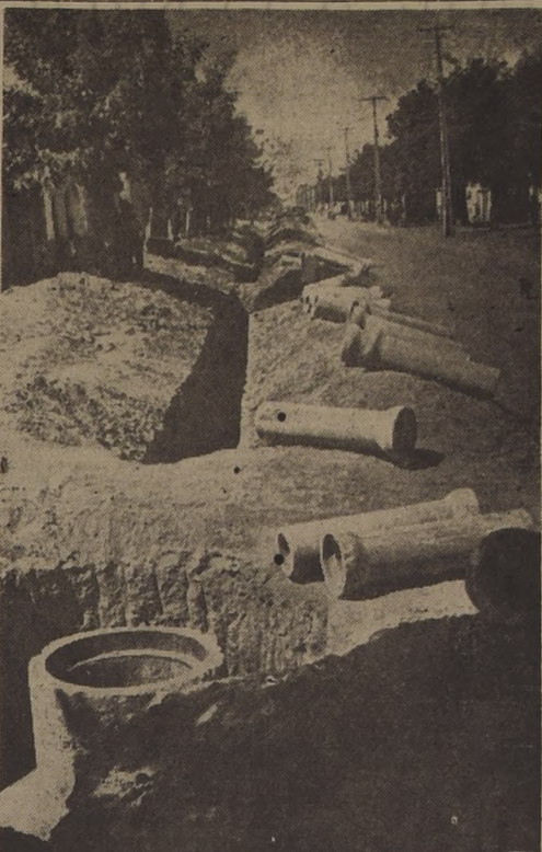
OBRAS DE ALCANTARILLADO.—Estado de los trabajos de alcantarillado de la calle Constantino de la Comuna de Quinta Normal. En primer plano puede verse una de las matrices de esas obras. En segundo plano, los tubos de los nuevos servicios que quedarán terminados a corto plazo. Los trabajos se llevan a un ritmo acelerado, lo que permitirá a esta progresista comuna contar con estos servicios esenciales para la salubridad de la población.
