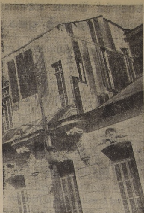
RUINOSO ESTADO DEL EDIFICIO DEL INSTITUTO COMERCIAL DE CONCEPCION. Desde la semana pasada dejaron de asistir a clases los alumnos de este Instituto...
