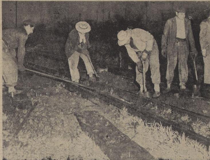
ONCE BOMBAS ESTALLAN EN LAS LINEAS FERREAS DE BUENOS AIRES.— Cerca de la localidad de Sáenz Peña (Provincia de Buenos Aires), obreros proceden rápidamente al cambio de rieles cortados por atentados que, según información oficial, corresponden a un plan político de perturbación de la tranquilidad pública. Fueron once bombas las que se colocaron en las vías férreas de alrededores de Buenos Aires.— (Foto ACME).
