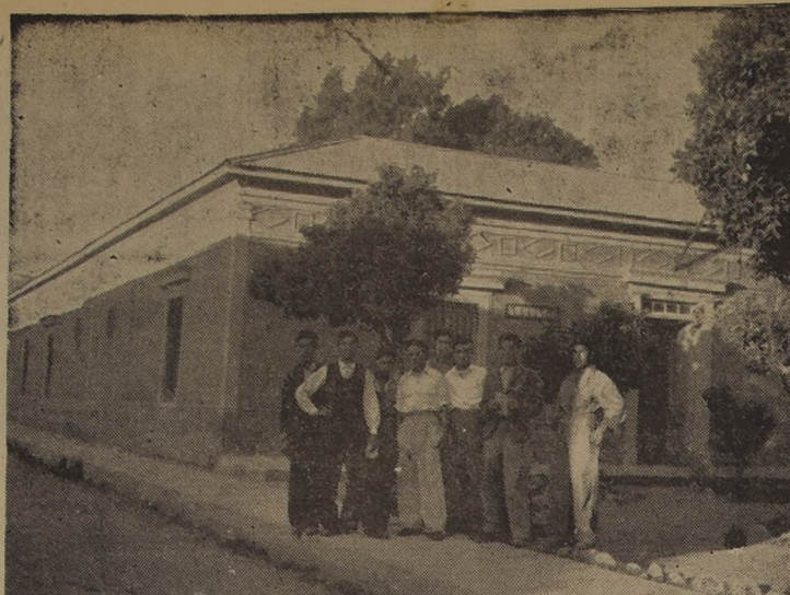
ESCUELA DE VICUÑA ESTA SEMIDESTRUIDA.- Un grupo de alumnos de la Escuela Industrial de Vicuña, conversa frente al edificio, que por el estado de sus muros, desmontados y agrietados, amenaza derrumbarse...
