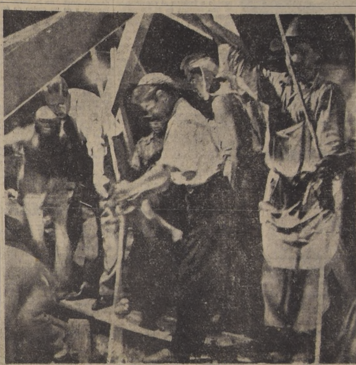
VICTIMAS DE LA IMPREVISIÓN.— Dos muertos fue el balance del derrumbe ocurrido anoche en un edificio en construcción en Hernando de Aguirre 1111. El accidente, según declaraciones de un ingeniero de la Caja de Accidentes del Trabajo, se originó como consecuencia de la negligencia de parte de los constructores. La fotografía muestra el momento en que se trabaja en el rescate de las víctimas, lo que recién se logró después de la medianoche.
