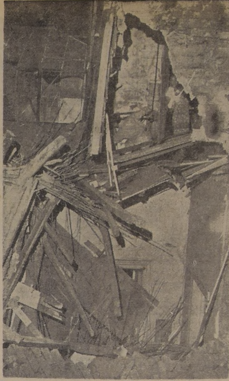
El grabado muestra un aspecto del derrumbe que se produjo anoche en Arturo Prat 259, como consecuencia de las excavaciones que se realizan en ese sector, donde se construyen un teatro y un laboratorio. No hubo desgracias personales, pero tres familias perdieron su mobiliario, y debieron ser evacuadas ante el peligro de nuevos desplomes.
