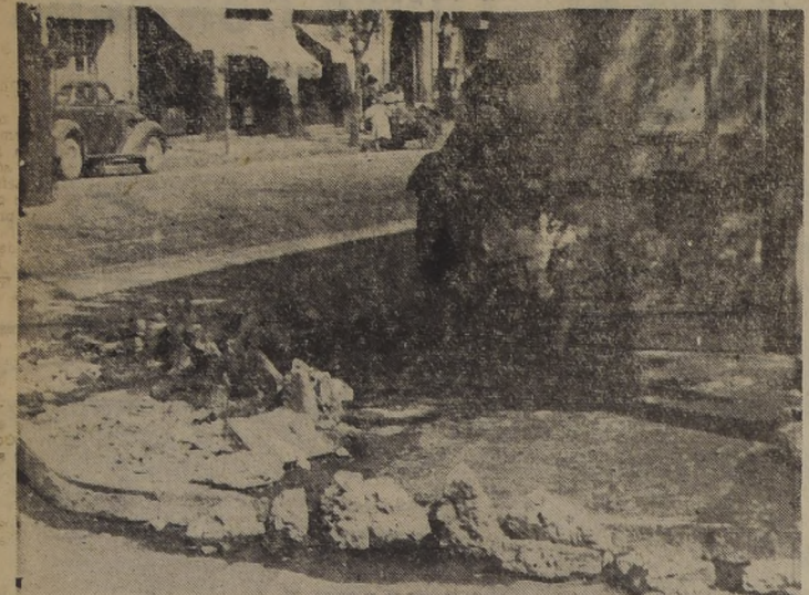
HUELLAS DE DESTRUCCION.— Está bien que la Municipalidad se preocupe de repavimentar las calzadas y veredas. Bastante caro paga el vecindario, como para que se le atienda como es debido en la reposición de calles. Pero dejar escombros repartidos en todas partes, y que producen la impresión de que las obras han quedado inconclusas, es desvirtuar la finalidad que debe cumplir la autoridad comunal. En el grabado: esquina de Ricardo Cumming con San Pablo, donde desde hace nueve días están obstruyendo el tránsito estos trozos de pavimento.
