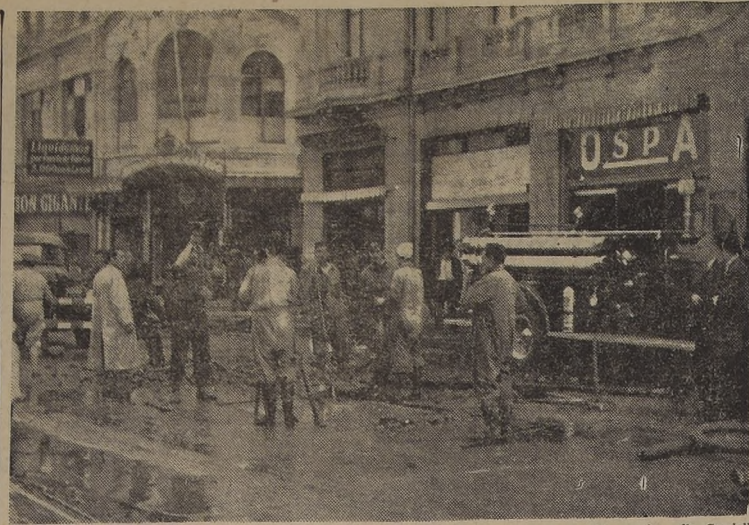
INUNDACION EN CALLE DE VALPARAISO.—Al romperse la cañería matriz de agua potable en la calle Condell, quedaron inundados varios negocios, provocando daños por un monto superior a un millón de pesos. El grabado muestra los trabajos de reparación, que se realizaron en colaboración del Cuerpo de Bomberos.
