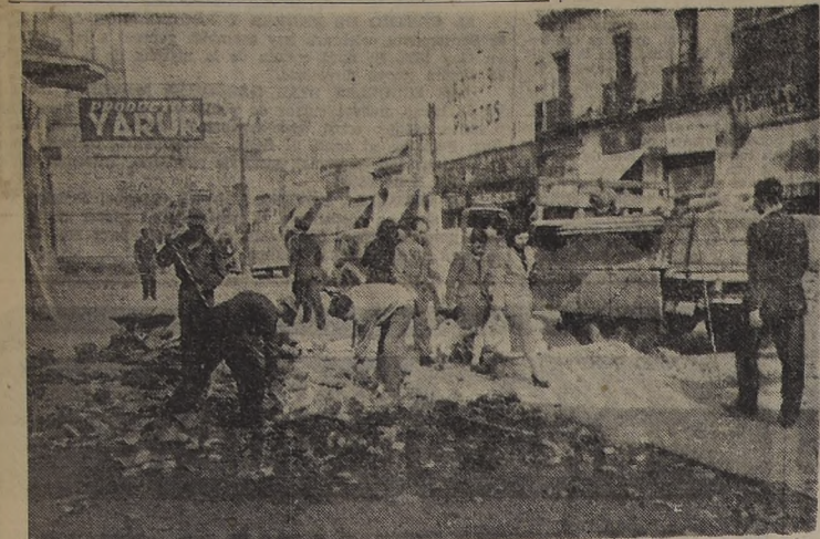
REPARAN PAVIMENTO DE SAN DIEGO, A "FULL TIME". La reparación total de las calzadas y aceras de la calle San Diego se está efectuando aceleradamente, en jornadas a "full time", estimando los técnicos que estos trabajos quedarán terminados a las 12 horas de la noche. Por su parte, el Departamento de Tránsito, estudió la supresión del estacionamiento a ambos costados de esa conglomeraada vía, que conduce al sector sur. En el grabado, un aspecto de las reparaciones.
