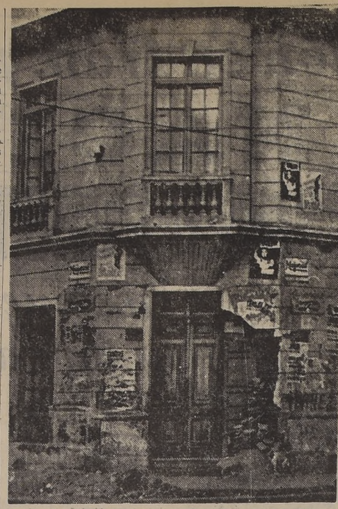
ESQUINA PELIGROSA - La esquina de Natiel con Avenida Matta, donde chocó violentamente un camión, dejando este viejo inmueble en una situación de peligrosa inestabilidad. El Alcalde ordenó el desalojo y la demolición inmediata del segundo piso, donde viven tres familias.
