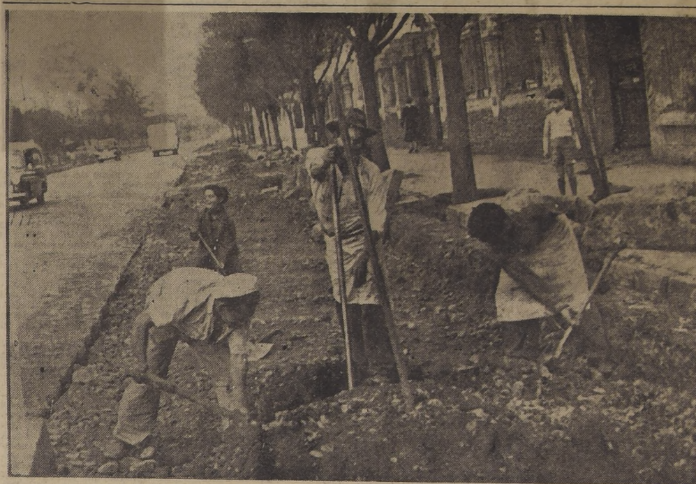
AMPLIACION DE AVENIDA IRARRAZAVAL.— Mediante el retiro de las soleras, la Avenida Irarrázaval será ampliada de 9,60 a 17,40 metros entre Julio Prado y Pedro de Valdivia. Se calcula que los trabajos, que comenzaron hace una semana, durarán un mes. En la remoción de las soleras se emplean cuarenta operarios que trabajan jornadas diarias de ocho horas. El intenso y creciente movimiento de autobuses, camiones, trolebuses y micros hacia de suma urgencia la realización de esta obra que beneficia a más de cien mil habitantes. En la foto, los obreros Manuel Alcántara, José Godoy y Jorge Escobar sorprendidos en plena labor.
