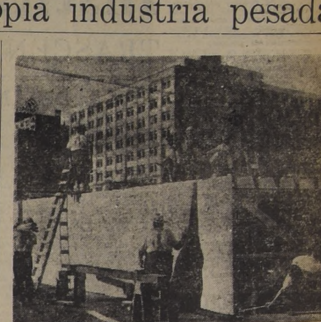
ARREGIOS PARA LA LLEGADA DE PERON. — Febrilmente han trabajado los obreros en el arreglo de calles y plazas, por donde atravesará el cortejo presidencial durante la llegada del Primer Mandatario argentino. En el grabado de arriba puede observarse dando término al estrado monumental desde donde Peron e Ibañez presentarán el grandioso desfile de tropas que se hará en honor del conductor de la nación argentina. A la derecha, obreros Municipales limpian focos y cambian luces de la Alameda. Se trata de dar el mejor aspecto para cuando, mañana a las 18 horas, los dos Jefes de Estado inicien su viaje desde la Estación Alameda hasta Plaza Bulnes. Los alrededores de la Estación Central, puerta de entrada del General Peron, están siendo sometidos a rápidas reparaciones y limpiezas y han sido desalojados de sus alrededores, momentáneamente, los vendedores de frutas, quesos y estacionamientos de micros.
