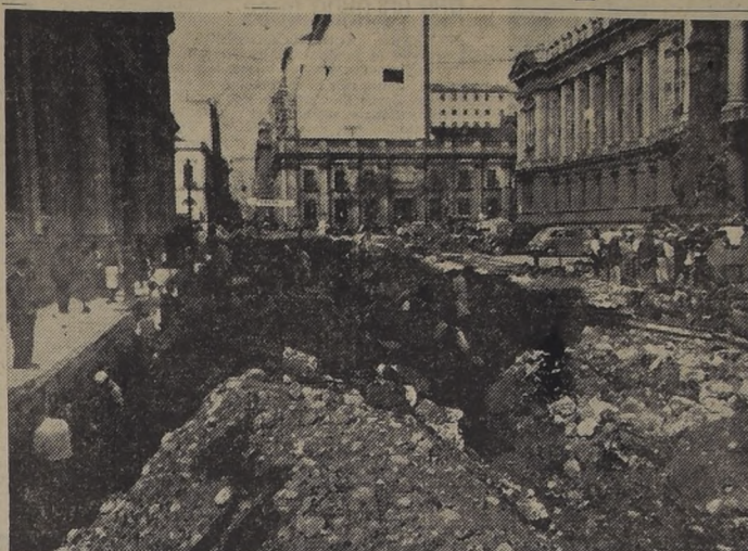
QUINIENTOS OBREROS TRABAJARON AYER.— Mayor actividad hubo ayer en las diferentes de la que espera un millón de santiaguinos ver prontamente pavimentada, 500 obreros trabajaron, dando un aspecto de dinamismo, como podemos apreciarlo en el grabado
