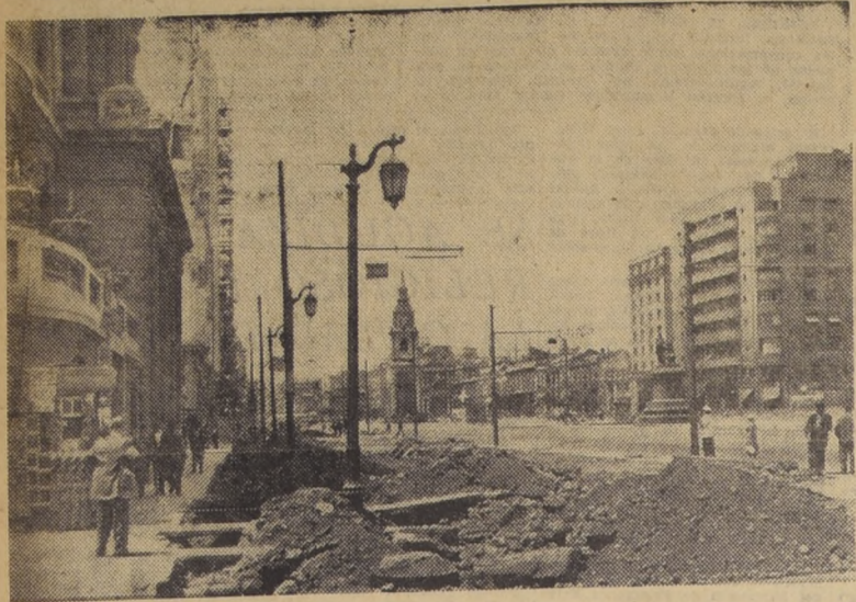
Las veredas destruidas, que tanto amargan a los pesimistas, son el precio obligado del progreso. Las cañerías diseñadas para otros tiempos, no resisten las sobrecargas que exige la ciudad nueva.
