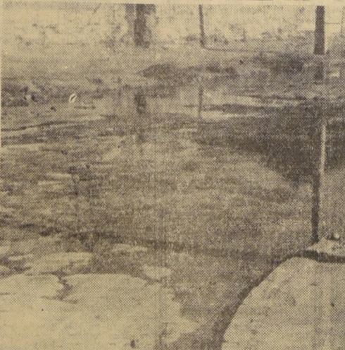
En el grabado se puede apreciar el estado desastroso en que se encuentra la calzada de un importante sector de la calle Santa Rosa.
