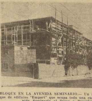
BLOQUE EN LA AVENIDA SEMINARIO.— Un aspecto del bloque de edificios "Empart" que ocupa toda una cuadra de la Avenida Seminario al llegar a Providencia.
