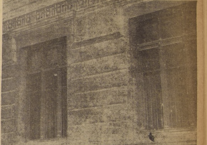
Los desmanes ocasionados por las turbas no se limitan a la destrucción de la propiedad del Palacio de los Tribunales de Justicia, ubicado en la calle Morandé, frente a uno de los costados del Congreso Nacional. Ventanas, puertas y mullas fueron blanco de los impactos de toda clase de proyectiles rústicos lanzados por los manifestantes. Quedó así escrita una negra página en la historia de nuestra vida cívica. En el grabado pueden observarse los efectos de las pedradas en algunas de las ventanas del indicado edificio.
