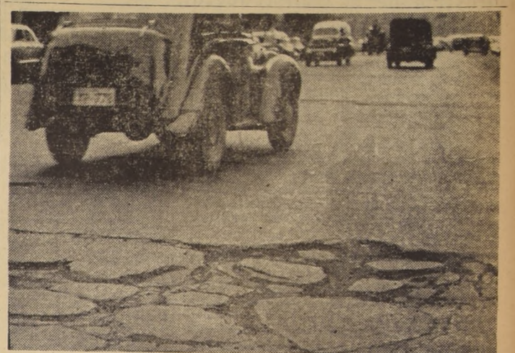
En esta parte del pavimento ya ha comenzado la desintegración de la capa de asfalto, debido a que las lluvias y calores han hecho perder al bitumen sus cualidades de adherencia y cohesión. Con la adquisición de maquinaria alemana, llegada ya al país, la reposición del pavimento será posible hacerla en tiempo record.
