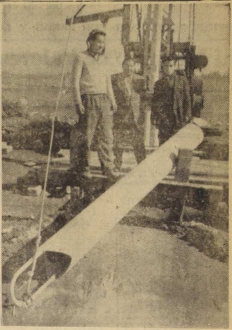
Una moderna máquina excavadora permitió la construcción de un pozo de cien metros de profundidad, de donde se extrae el agua para la distribución en la ciudad de Requinoiva, y cuyas obras se entregarán en algunos días. En el grabado, un grupo de obreros realiza los últimos trabajos de conexión de cañerías.
