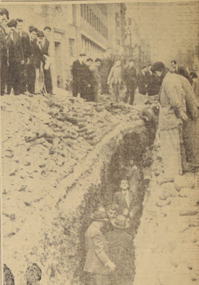
Interior de la profunda zanja abierta por obreros especializados de la EAP, aparecen técnicos de la Empresa, el Director de Museo Histórico y reporteros gráficos, cerca de la boca del túnel.
