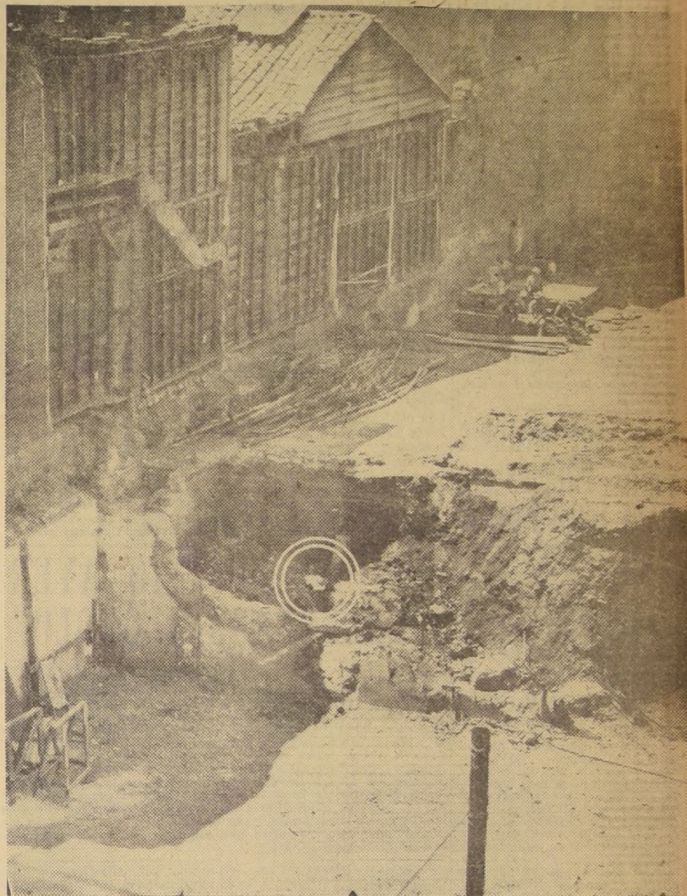
BAJO 3 TONELADAS DE CONCRETO. El obrero de la construcción, Antonio Edgar Cárcamo encontró la muerte ayer en la mañana cuando 3 toneladas de concreto cayeron sobre él mientras trabajaba en la construcción del edificio que se levanta en Estado esquina de Huérfanos, el antiguo solar de Gath y Chaves.
