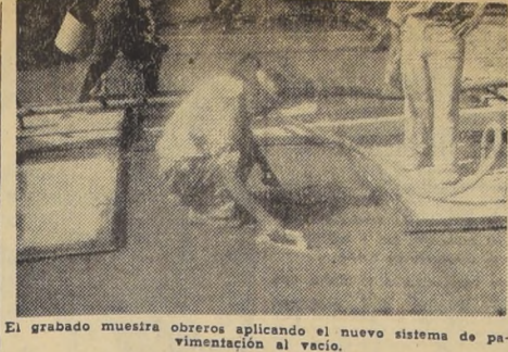
El grabado muestra obreros aplicando el nuevo sistema de pavimentación al vacío.
