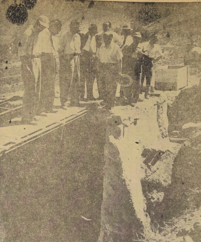
VISITA A INSTALACIONES DAÑADAS. — Grupo de periodistas que visitaron las obras de reparación en la planta de Los Queltehues, de la Compañía Chilena de Electricidad, que sufrió gravísimos daños por la cadena de sismos en el Cajón del Maipo. Los acompañan, en la foto, el Vicepresidente Adjunto, Sr. Jackson Hoagland, Gerente de Explotación, D. Rafael Herrera; Ingeniero Jefe, don Andrés Poch; Jefe de Publicidad, D. Rosaura Salas y otras personas.
