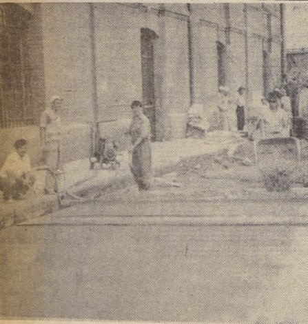
Los obreros de la Administración del Puerto de Valparaíso, trabajando en la pavimentación y transformación de la calle Varas, considerada como la puerta marítima de Chile, ya que por ahí transitan los numerosos pasajeros que viajan en los transatlánticos que atracan al Sitio Tres de la Aduana.
