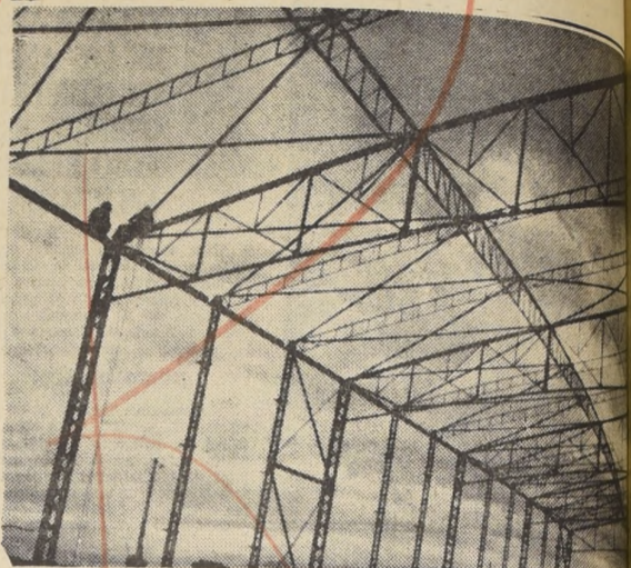
Detalle de una de las sólidas y bien diseñadas estructuras metálicas que forman la Bodega de Azúcar de IANSA.
