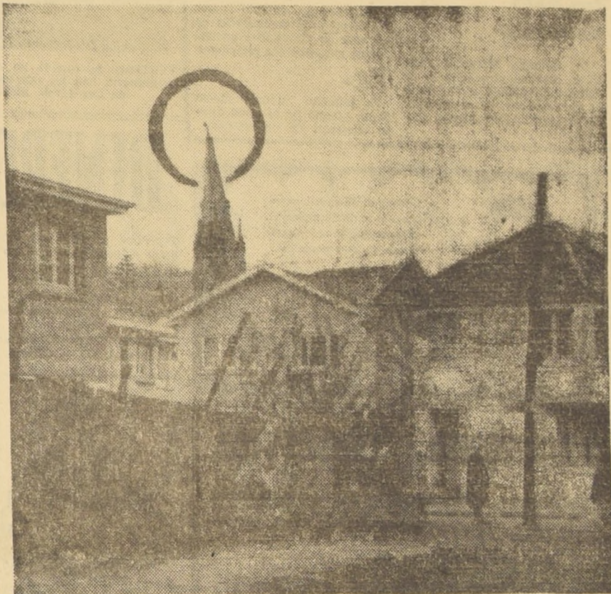
Uno de los numerosos barrios populares de Concepción que fueron gravemente dañados por el movimiento sísmico de la mañana de ayer. Puede observarse, al fondo, la inclinada torre de una iglesia que recibió agrietaduras.
