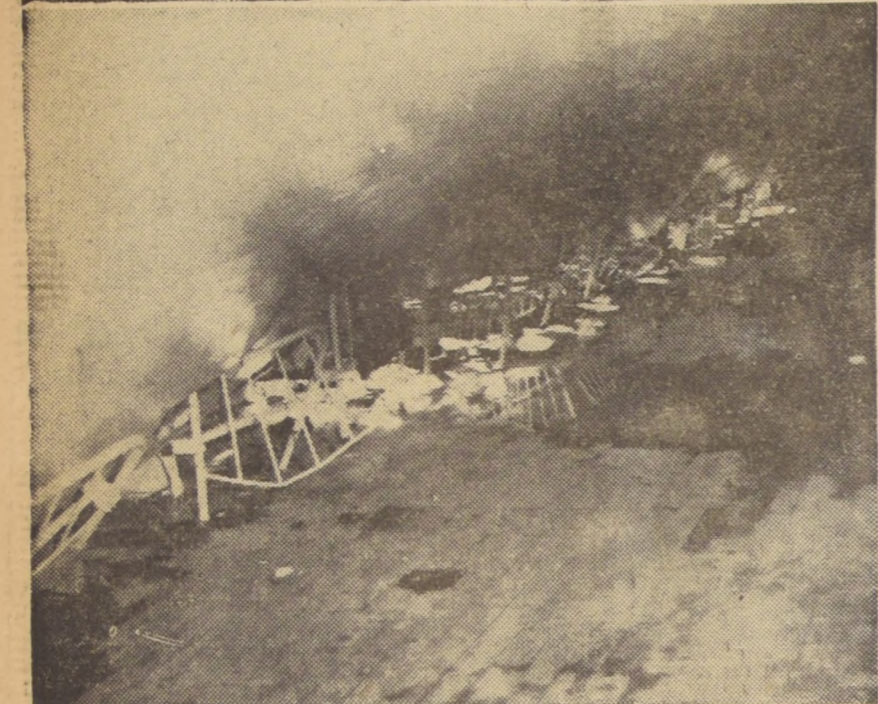
ESTAS DOS IMPRESIONANTES vistas muestran el estado como quedó el antiguo edificio del Buen Pastor, de Concepción. Arriba, se alcanzan a ver los respaldos de los catres donde dormían las reclusas. Una techumbre que cayó completa aplastó una veintena de catres. Abajo, la misma escena vista desde el interior del dormitorio. En el Buen Pastor murieron cuatro jóvenes.
