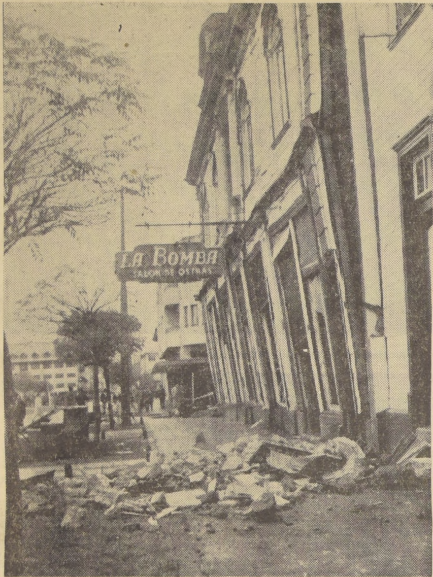
EN PLENA PLAZA DE PUERTO MONTT, este negocio está a punto de desplomarse. Se ha prohibido el paso de los peatones, y con mucha razón, porque después de ser enviada esta correspondencia, hubo de ser derribado.
