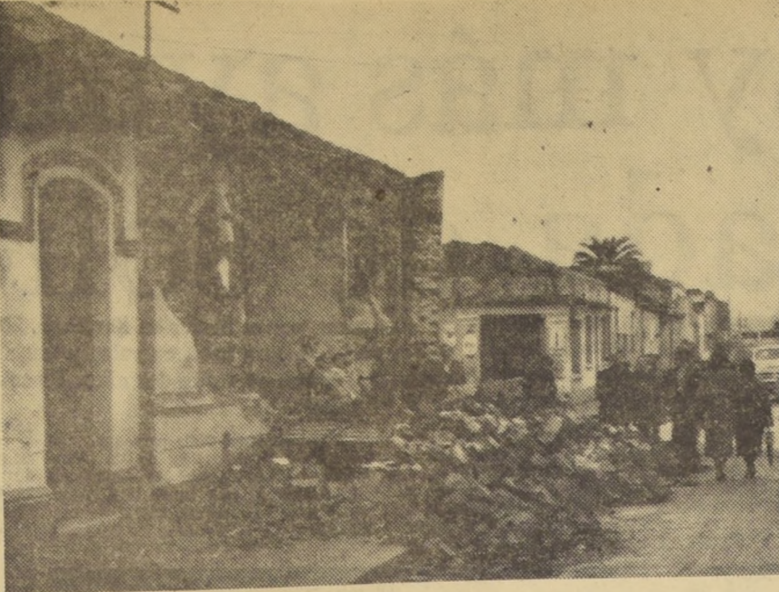
CAYO EL FRONTIS.— En el grabado, una esquina de barrio, en Concepción, muestra con elocuencia la magnitud de los efectos en este inmueble de adobe y tejas. Moradores y curiosos contemplan las ruinas. Comenzaron a trabajar poco después.
