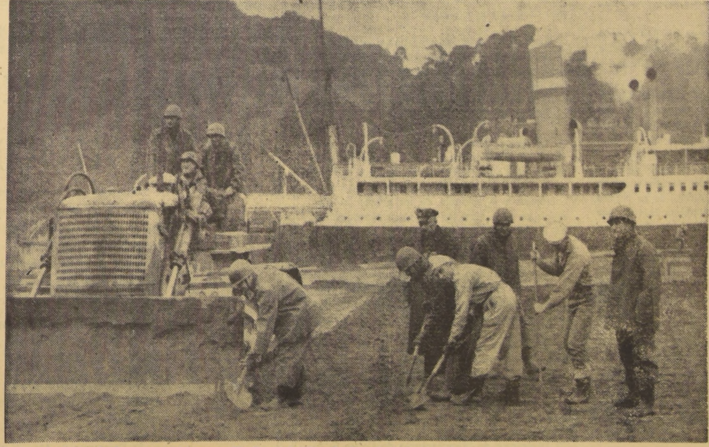
Con maquinaria pesada, la marinería del crucero "Prat" está habilitando el muelle de Angelmó. La bella caleta de pescadores de Puerto Montt sufrió daños de consideración con los sismos y la salida de mar. Sus pintorescos barcos, eternizados en telas y grabados de artistas chilenos y extranjeros, fueron barridos por las marejadas. El barrio levantado junto a ella se encuentra en el suelo, convertido en escombros. Pero los chiletes, que hicieron de esta playa un paraíso de colores, relatos marinos y de viejas aventuras por los canales, no desean otra cosa que reconstruir Angelmó, mucho más bella que lo que fue antes.— (Foto de Eolo Nido Daza).
