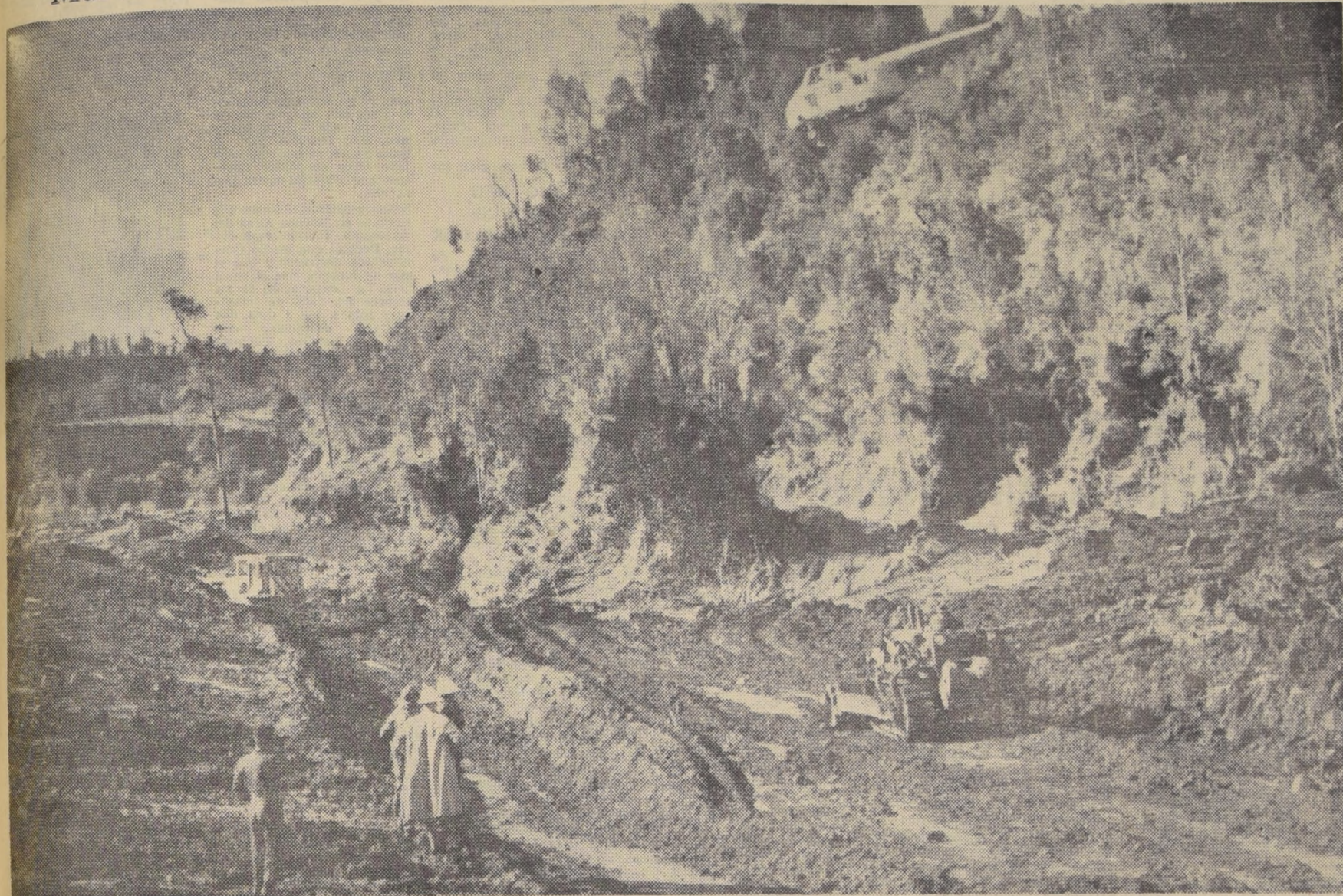
EN EL FRENTE DE LA BATALLA.— Esta fotografía condensa la dramática lucha que los técnicos de la ENDESA, de la CORFO y Servicios Mecanizados Agrícolas (fue apoyado por helicópteros de la FACH, los cuales transportan petróleo y personal) están librando en la zona amenazada por la crecida del lago Riñihue, para impedir que el rebalse provoque un nuevo desastre, tan devastador como los sismos que llevaron desolación y muerte a la hermosa región sureña. Mientras las máquinas abren surcos gigantes que puedan en el momento decisivo encauzar el torrente, neutralizando su potencia arrolladora.
