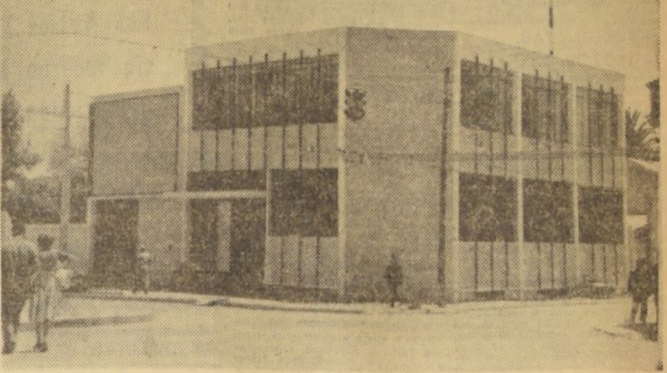
MELIPILLA.- Se encuentra prácticamente terminado el edificio que construye la Compañía de Teléfonos de Chile para la nueva planta automática de esta ciudad. En este edificio quedarán instaladas la planta automática, que reemplazará al sistema magneto actualmente en uso; las nuevas posiciones de larga distancia, las oficinas comerciales y demás dependencias de la empresa. Estas instalaciones representarán un 75 por ciento de aumento sobre las líneas existentes. El costo de estos trabajos, que se espera entregados al servicio público dentro de pocos meses más, se estima en una suma superior a los 450.000 escudos. (Correspondal).
