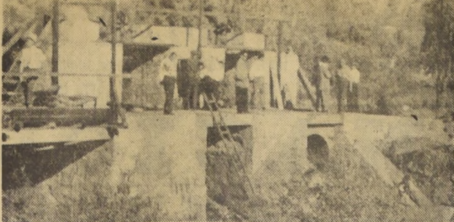
Un boquete de tres metros de alto por dos y medio de ancho, produjo el impacto de las aguas del río Maipo, en las compuertas Las Coloradas...
