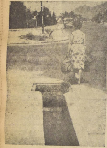
Este sifón está abierto en el cruce de las avenidas Américo Vespucio y Apoquindo. Es una de las tantas "trampas mortales" que existen en la periferia santiaguina.
