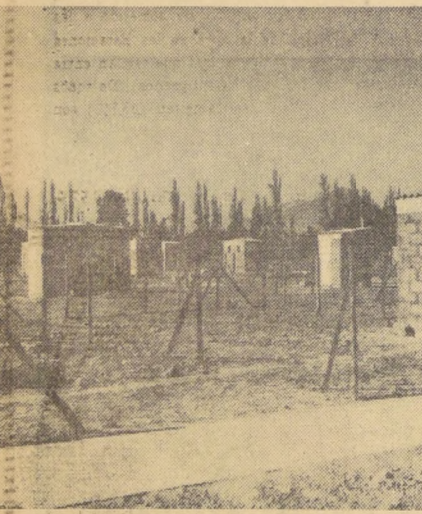
Docientos ochocientos sitios urbanizados entregó la CORVI en Copiapo, a los pobladores que fueron desalojados de los terrenos ubicados en calle Freire, por el paso de la Carretera Panamericana. En estos terrenos los habitantes construirán ellos mismos sus viviendas en las
