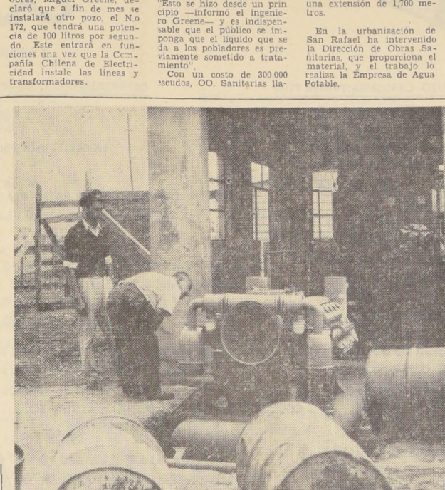
El ingeniero jefe de las obras de urbanización que se realizan en Santa Adriana, Miguel Greene (a la derecha), examina el pozo N.º 171, que funciona con motor DIESEL, entregando una dotación de 70 litros por segundo. Cinco de estos sondeos abastecen en forma normal a los pobladores de Santa Adriana, que ven solucionados sus problemas de escasez
