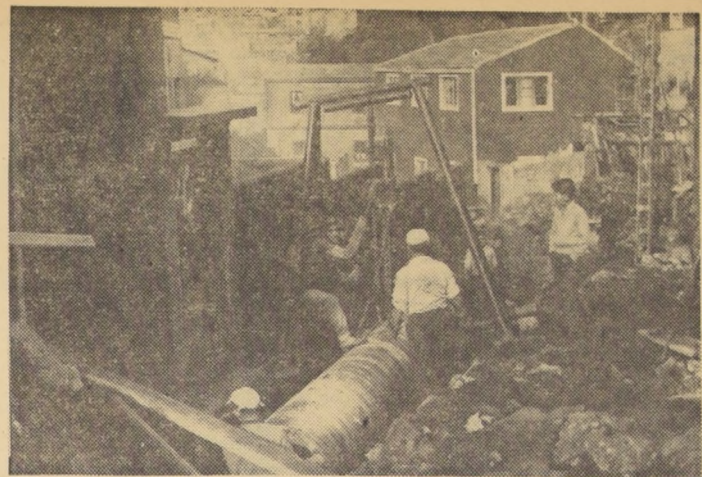
La aprobación de un préstamo por cerca de 9 millones de escudos por parte del BID permitirá a la Empresa de Agua Potable iniciar un plan de vastas proyecciones, encaminado a ofrecer un mejor servicio a todo el país.
