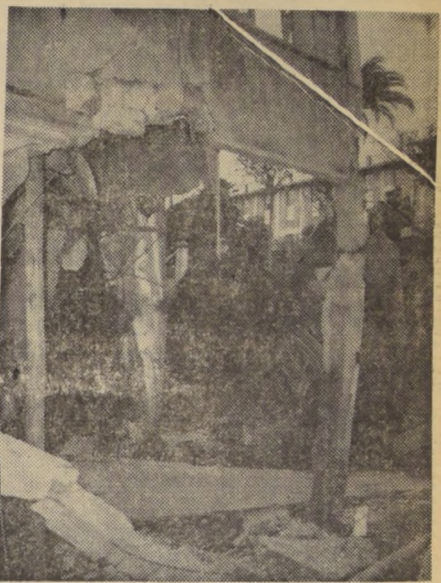
VALPARAISO.— EXPLOSION EN HOSPITAL NAVAL.— Daños por sesientos millones de pesos ocasionó la fuerte explosión que se produjo en la noche del lunes pasado, en el Hospital Naval de Playa Ancha. EN EL GRABADO, un aspecto de los cuantiosos destrozos sufridos por el edificio, el que deberá ser demolido en un gran sector.
